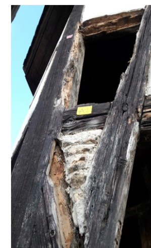
Vergammelte Balken am Turm
